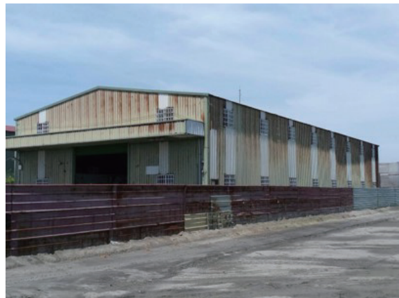
外觀鏽蝕嚴重，屋頂烤漆板需更換
